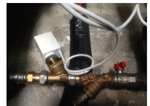
Moteur SK monté sur corps de vanne du PC en gaine palière
